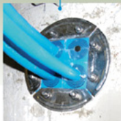
Registros: Sellado de cables de alimentación en arquetas enterradas.
