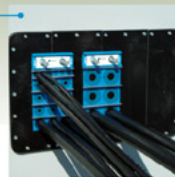
Caseta de la estación base de 3G: Sellado de los cables de red que atraviesan la pared.
