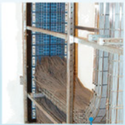
Estación de conmutación: Sellos para los cables que atraviesan suelos y paredes de la estación de conmutación.
