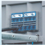
Ferrocarril: Sellado de cables para sistema GSM-R a través del suelo y paredes de la caseta.
