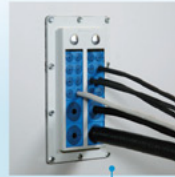
Armario exterior: Sellado de los cables que pasan del exterior al interior del armario.
