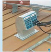
Enlace de radio: Sello de cable en el tejado para los cables de antena que atraviesan la construcción del tejado.
