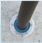
Edificios: Entrada de cables en los edificios.
