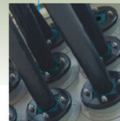
Caseta de la estación base: Solución redonda de sellado para las aperturas de las placas con entradas para los puertos.
